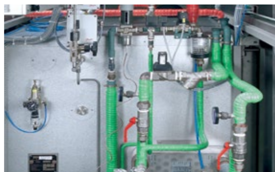
Aislamiento de la cámara y aislamiento de las tuberías codificado por colores
